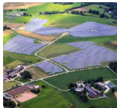
Die 30.000 Solarmodule des Solarparks Münchberg liefern Strom für 2.400 Haushalte.
