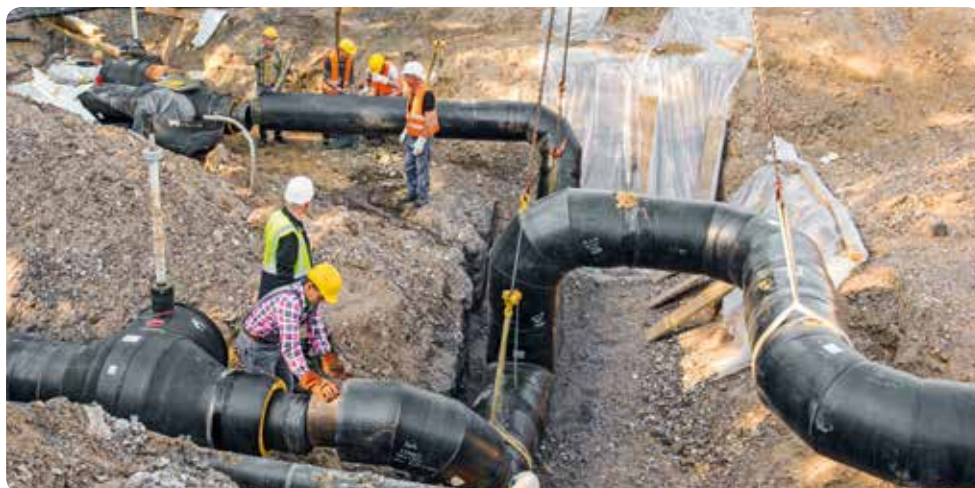
Ausbau in alle Richtungen: In ganz Köln wächst das Fernwärmenetz. Einen Schwerpunkt gibt es rechtsrheinisch. Dort ermöglicht der zweite Rheindücker neue Anschlüsse etwa in Mülheim, Deutz und Kalk.
