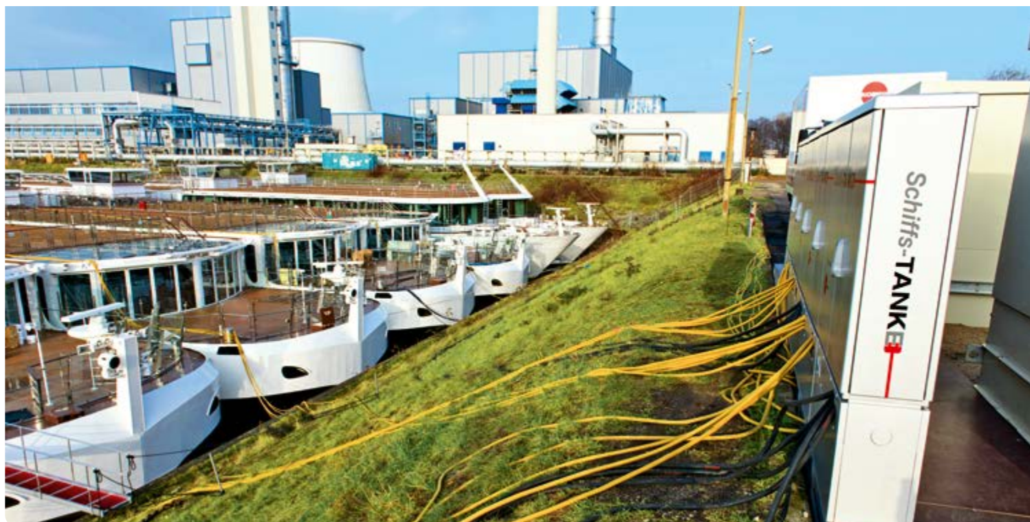
Stille, wo früher ein mit Diesel betriebener Stromgenerator wummerte: Gleich 14 Flusskreuzfahrtschiffe versorgen sich klimaneutral mit Landstrom der RheinEnergie.
