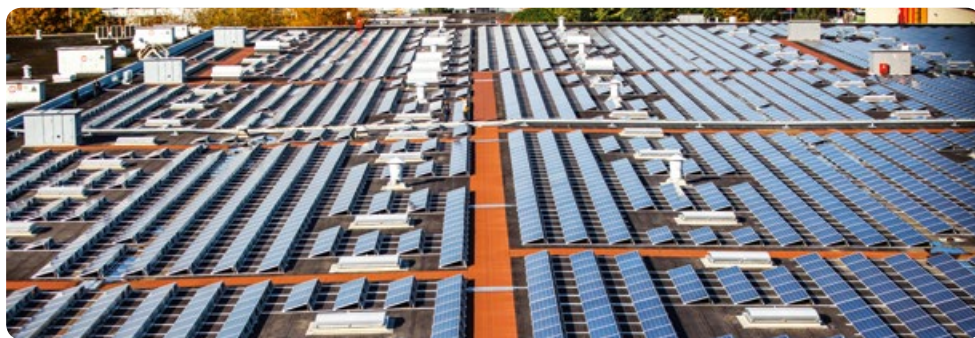
Unsere Solaranlage auf dem Dach des europäischen Ersatzteillagers von Ford in Köln-Merkenich ist die bisher größte in Köln.
