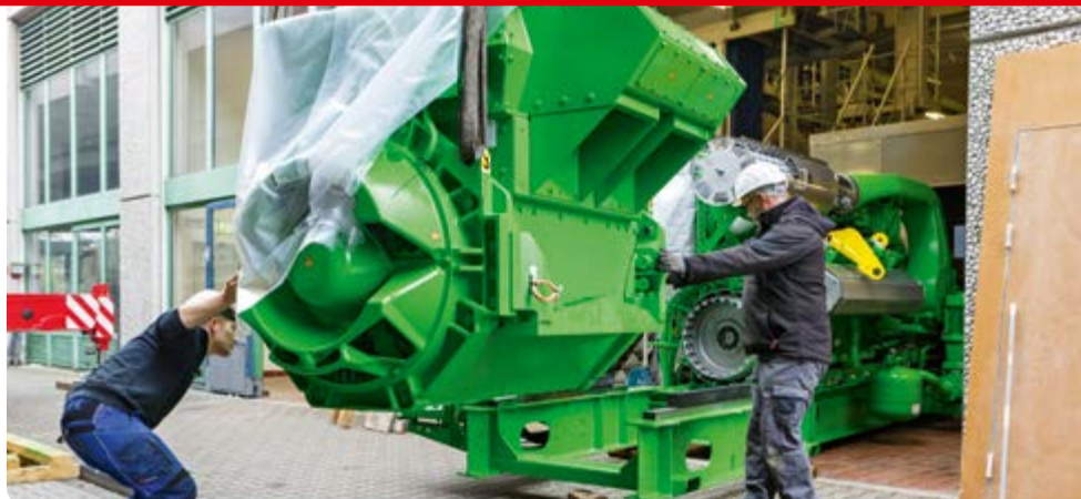
Grüne Technik für eine klimaschonende Energieversorgung: Das effiziente Blockheizkraftwerk deckt den Grundbedarf an Wärme und Strom auf dem gesamten Messegelände. Fernwärme der RheinEnergie liefert bei hohem Bedarf Extra-Wärme.
