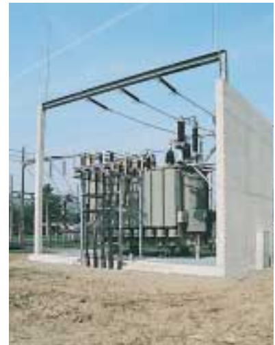
Abschirmwände dienen dem Brandschutz und schützen vor Schallimmissionen der Transformatoren.
