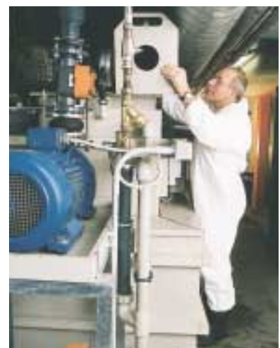
Der Dauerbetrieb von Klimaanlage erfordert eine regelmäßige Wartung.
