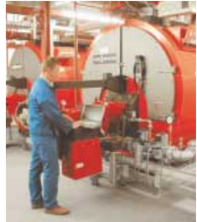
Für Gewerbe- und größere Wohnobjekte werden Nahwärmanlagen geplant, errichtet und betrieben.
