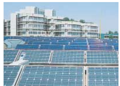
Die Generatoroberfläche der Photovoltaikanlage beträgt mehr als 50 m 2 .
